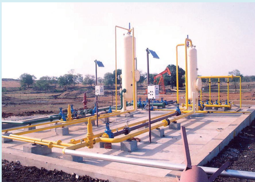
CNG GGS SITE
